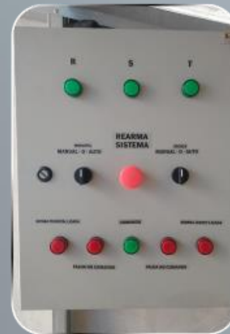
Quadro de Comando Bombas de Incêndio
