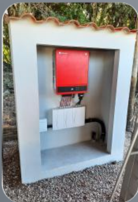
Inversor da usina Solar
