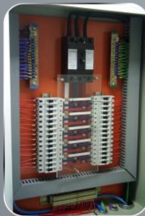
Quadro de Distribuição Industrial
